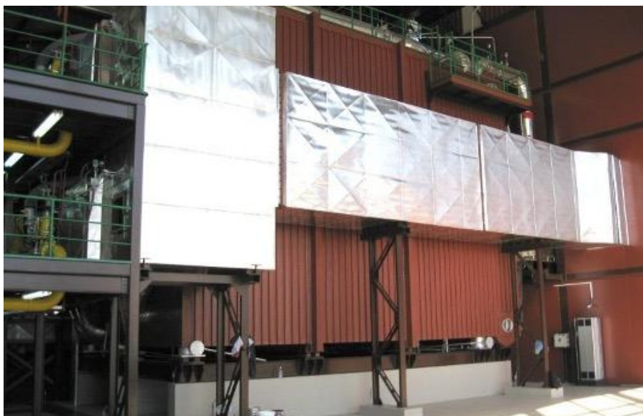
Naziv: Toplana "Zapad" Broj kotlova: 1 Lokacija: Novi Sad, Srbija Jačina kotla: 140 MW
