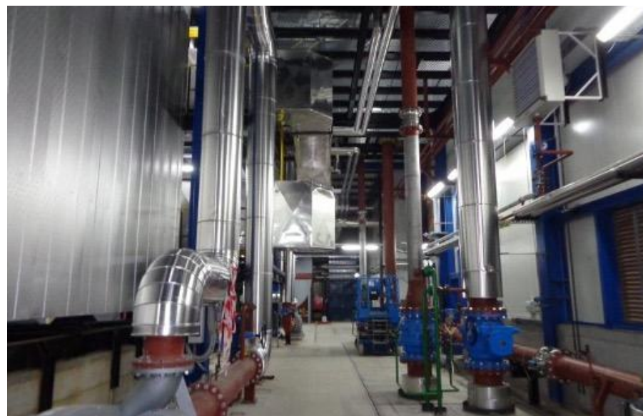
Naziv: Toplana "Šiška" Broj kotlova: 2 Lokacija: Ljubljana, Slovenija Jačina kotla: 58 MW
