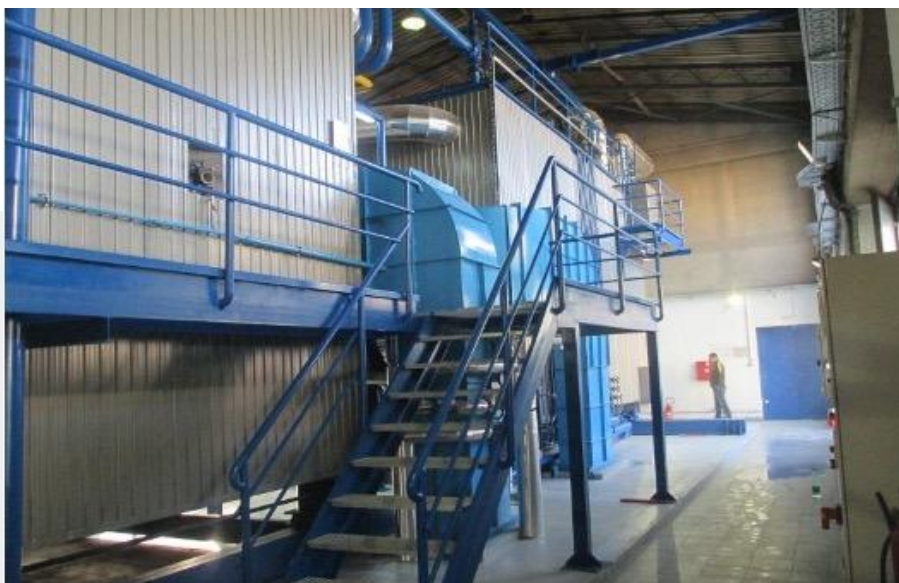
Naziv: Toplana "Jug" Broj kotlova: 2 Lokacija: Niš, Srbija Jačina kotla: 30 MW
